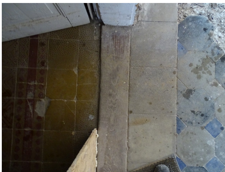
połączenie posadzki korytarza (po lewej) i holu (po prawej) z drewnianym progiem w drzwiach; widoczne zróżnicowanie poziomów obu posadzek
